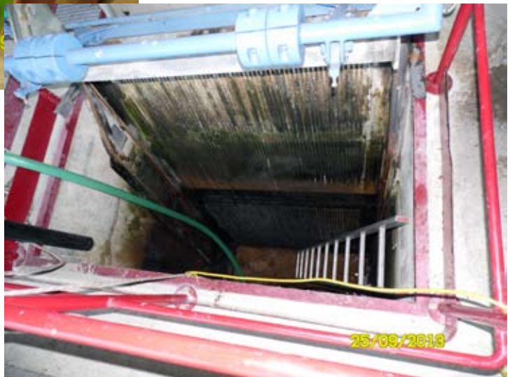
Grobrechen in der Wasserfassung
